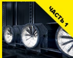
Воздушное охлаждение чистого пространства
