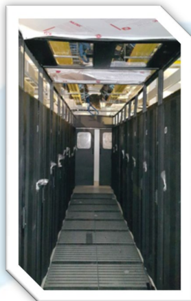
ЦОД «Газпромнефть-ОНПЗ», г. Омск
